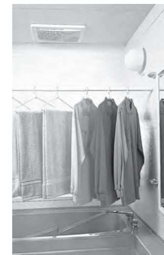
Exaustor e secador da sala de banho
